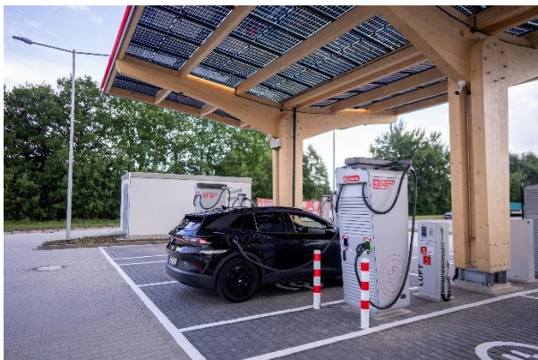
Bild: Ein Elektrofahrzeug lädt an einer Schnelladesäule.
